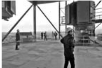
サスペンションプレヒータ上部
